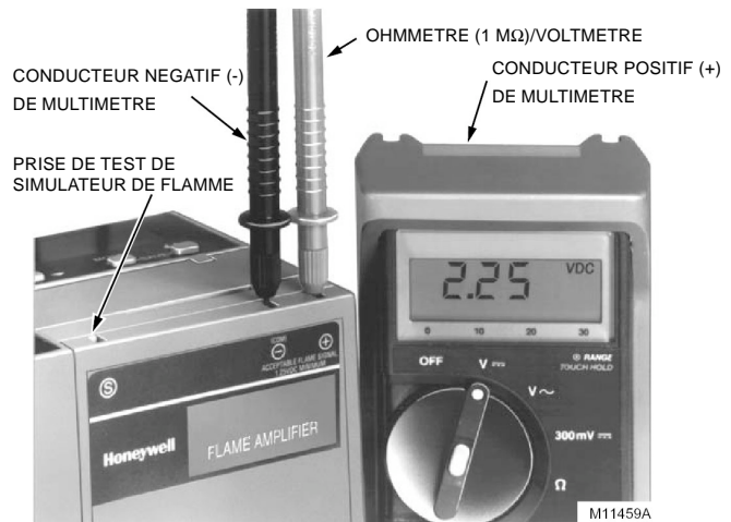
Fig. 4. Mesure de signal de flamme à l'aide d'un multimètre.
